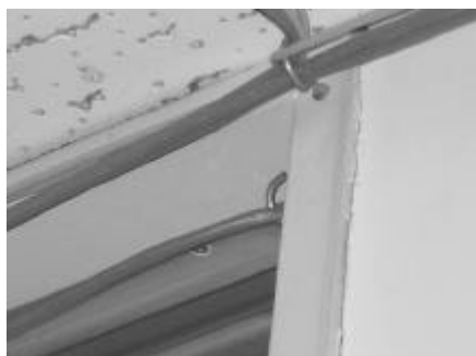
図1 廊下への配線
