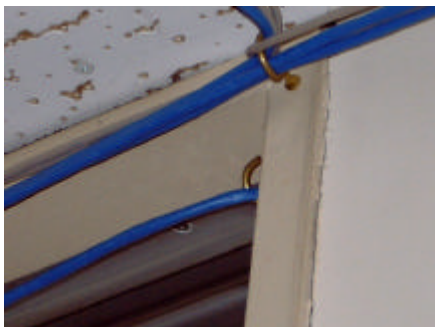
図1 廊下への配線
